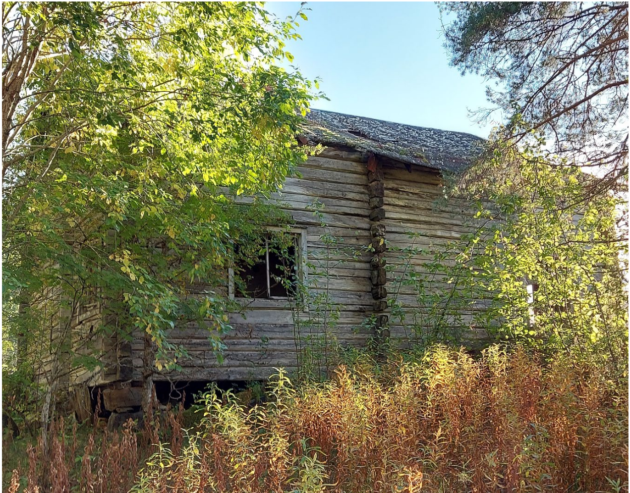
Kuva 13. Autioitunut talo Laivalassa. Kuvaussuunta 200° Kuva: Risto Nurmi, Maanala Oy.
